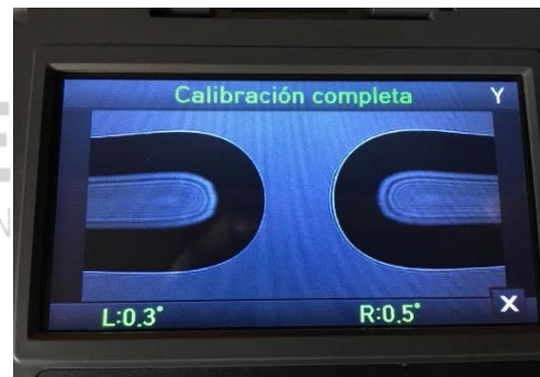
Img 4 Se reemplazo retenedor de fibra
